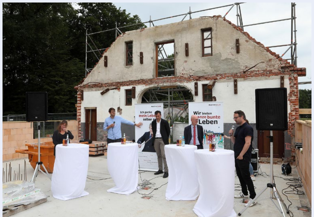
Das Fundament ist gelegt, die Giebelseite wird erhalten: Die Grundsteinlegung feierten mit Gästen: v.l. Hausleitung Margarethe Jakubiec, Benedikt Heche und Thomas Bretschneider, Martinsclub, Alexander Künzel, Bremer Heimstiftung, Jakin Schumpp, Architekt. Foto Martin Rospek
