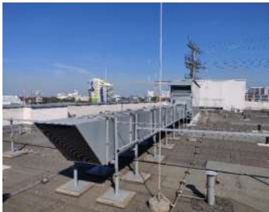
Abbildung 33: Lüftungsanlage auf Gebäudedach Herman-Blankenstein-Straße.
