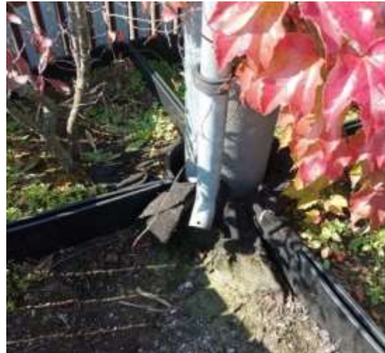
Abbildung 38: Pflanzkübel mit eingeleitetem Fallrohr in der Nahaufnahme.
