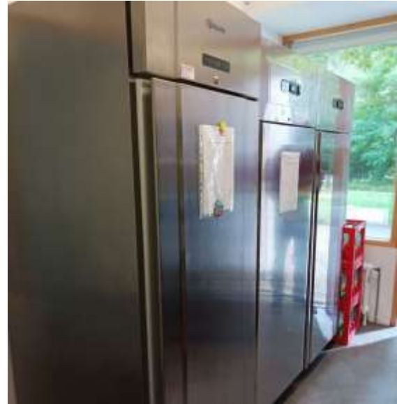
Abbildung 47: Kühlschränke in Vorratsraum produzieren viel Abwärme. Diese wird im Sommer zum Problem und führt zur Überhitzung des Raumes.
