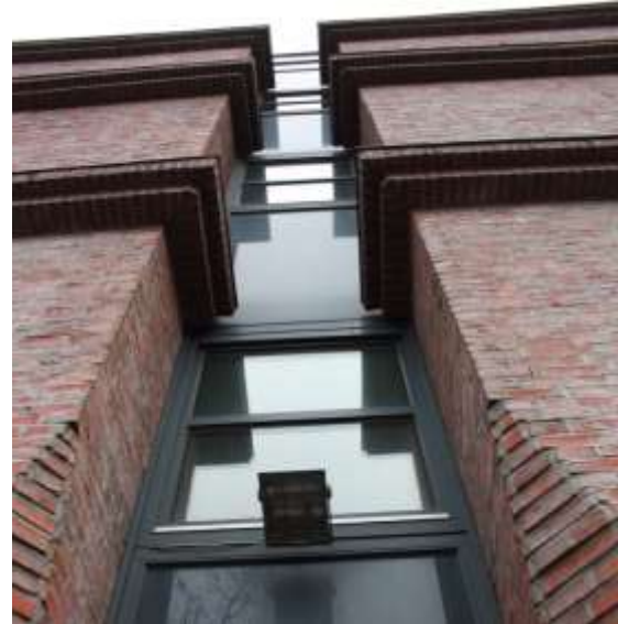
Abbildung 34: Stockwerkübergreifende Fensterfläche auf der Westseite der WfbM 1 mit schwarzer, hitzeabsorbierender Folienbeklebung.
