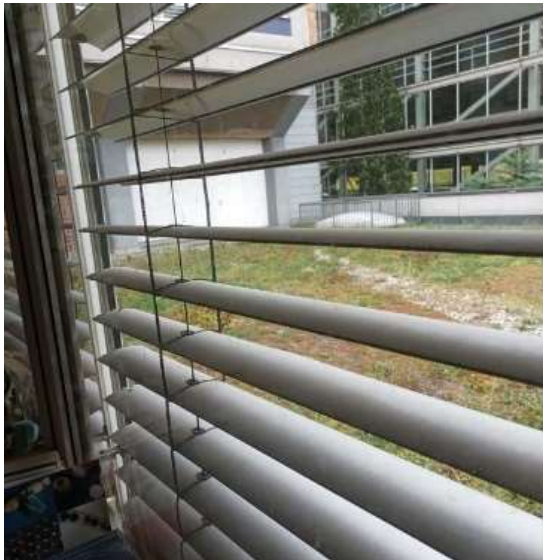
Abbildung 54: Raffstores an Südfenstern.
