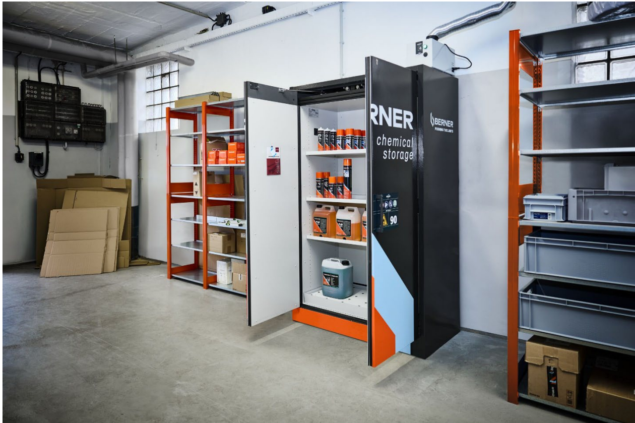
Ein Gefahrstoffschränk (Typ 90) mit Feuerwiderstand 90 Minuten zur sicheren Aufbewahrung entzündbarer Chemikalien.
